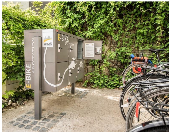
Abbildung 105: Ladestation für E-Bikes mit Schließfächern in Coburg
