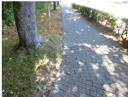
Abbildung 34: Bitburg, Saarstraße - schmaler Fuß- und Radweg mit Wurzelaufbrüchen
